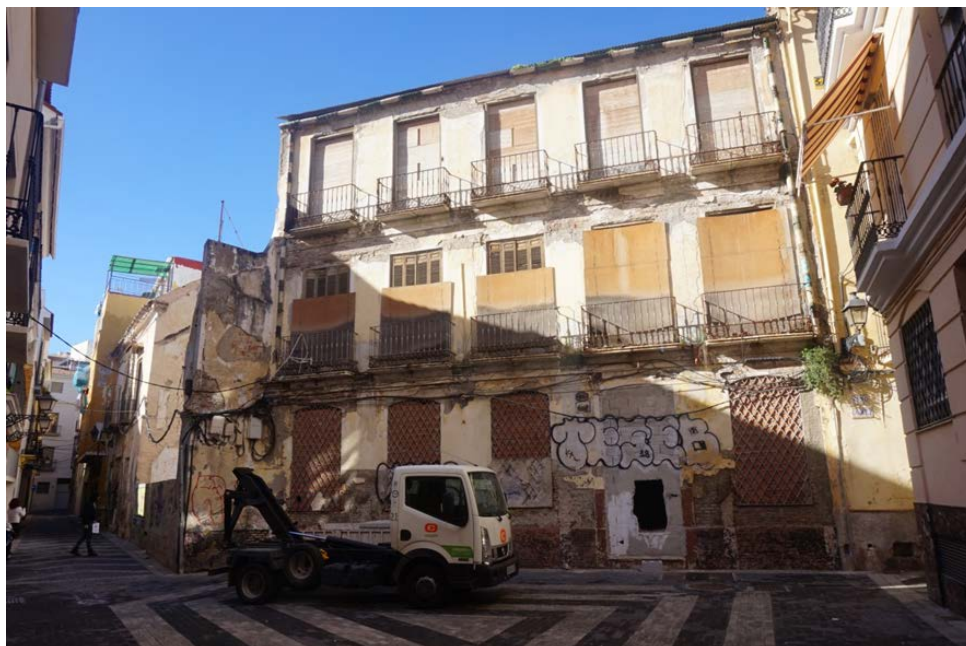
Detalle estado actual de los inmuebles.
