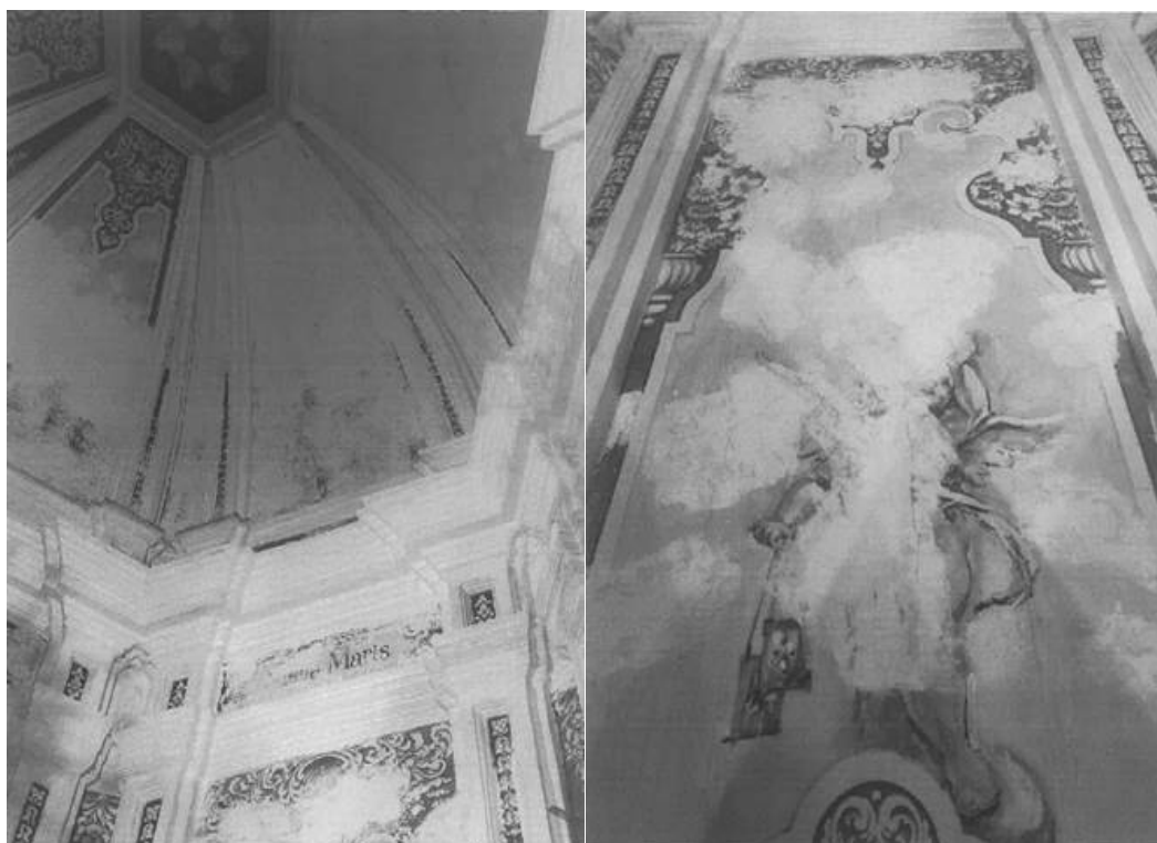
Vistas exteriores de la parroquia de Nuestra Señora del Carmen del Perchel y de paramentos interiores afectados por patologías del Camarín de Nuestra Señora del Carmen Coronada, previas a la actuación (Fuente: Informe Propuesta sobre la intervención)
