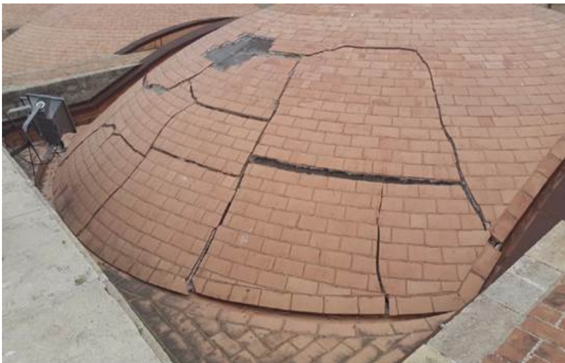
Vistas del estado exterior (fisuras y deslizamientos del solado) de las cubiertas de la Catedral previo a la actuación realizada 2019 (Fuente: Informe elaborado por INTEMAC)
